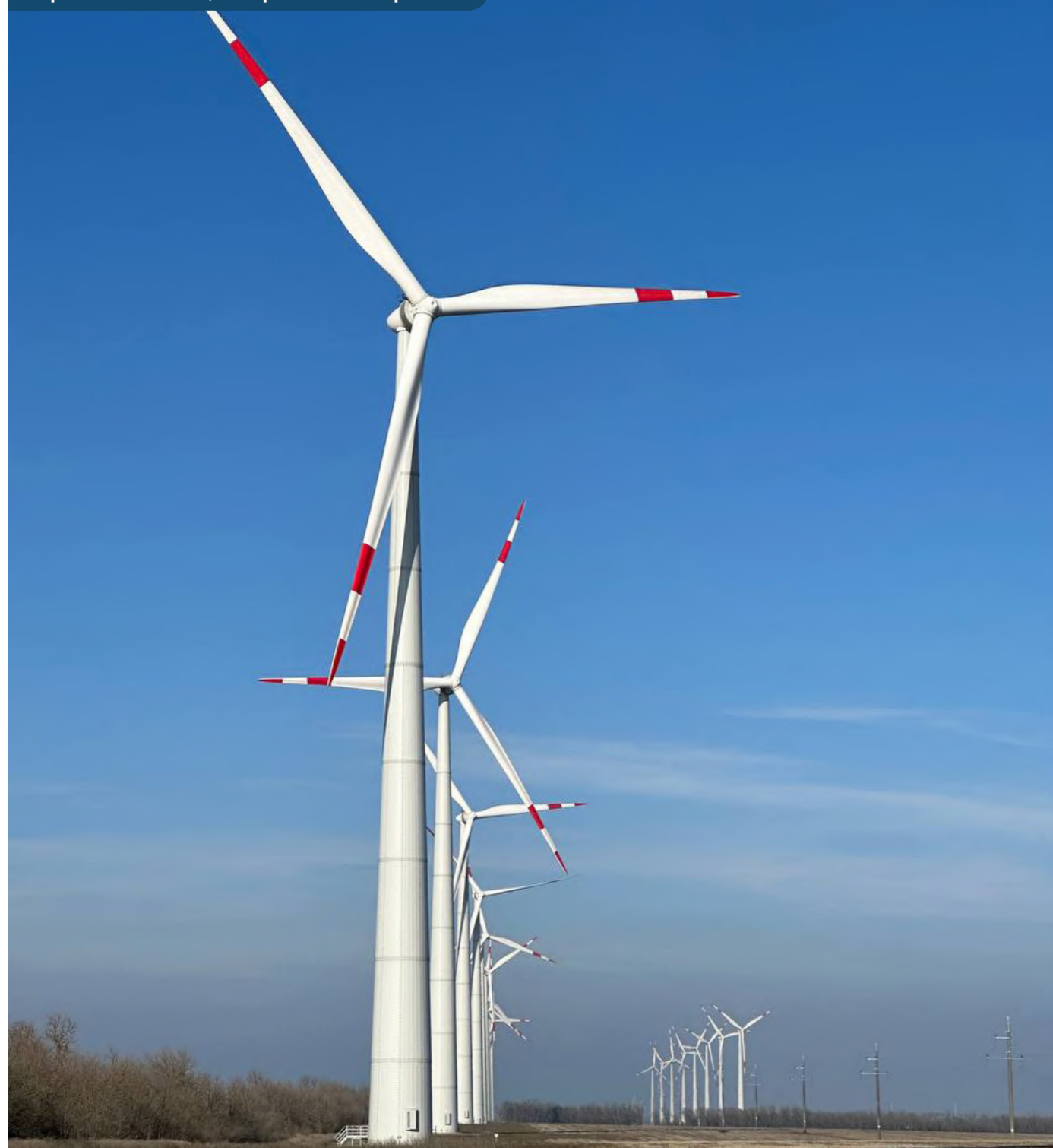
Берестовская ВЭС, Ставропольский край
